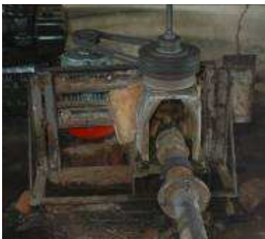
Zustand einer der ausgefallenen Mohnopumpen
